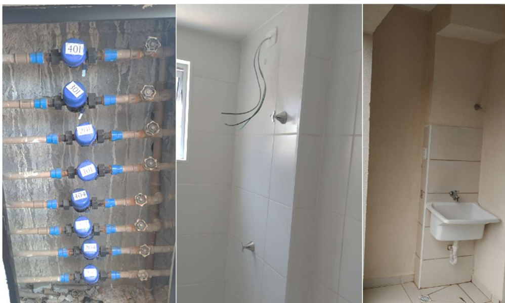
Localização dos registros na entrada e fundos do bloco, banheiro e Área de serviço/Cozinha.
