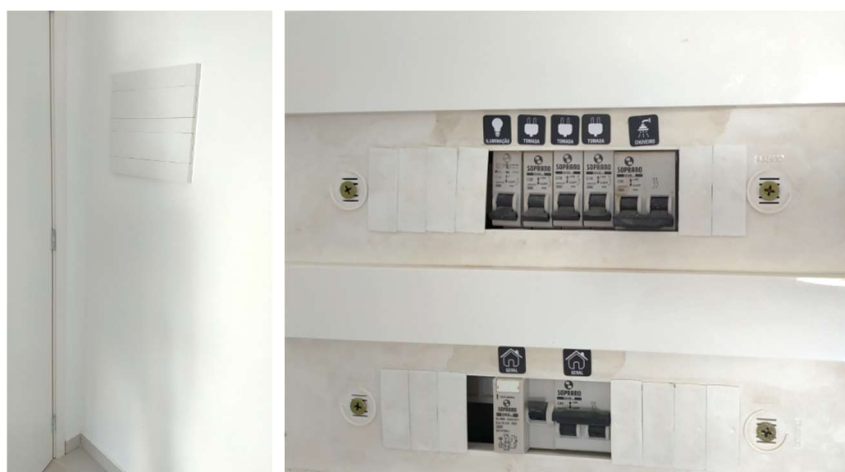
Imagem do Quadro de Distribuição
